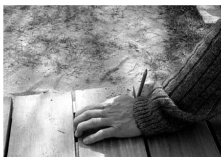
6. Plankerne lægges med en afstand på 8-10 mm. Dette giver ventilation og plads til træets bevægelser. Brug en afstandsliste og gerne styresnore.
